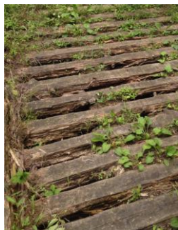
老朽化して隙間ができてしまった橋
